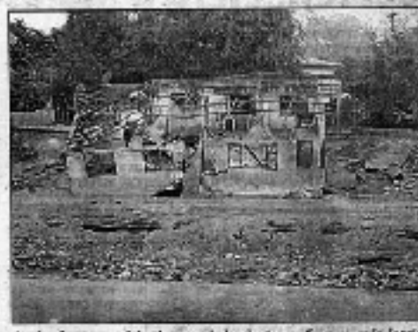
Aquí se observan uno de los dos muros de contención que fue arrasado de rajo de sus bases por la misma avenida que se llevó los puentes Cangrejal y Sopit.
