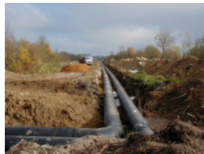
Svensk teknik och svenska rör gör fjärrvärmens effektivare och energisnålare.
