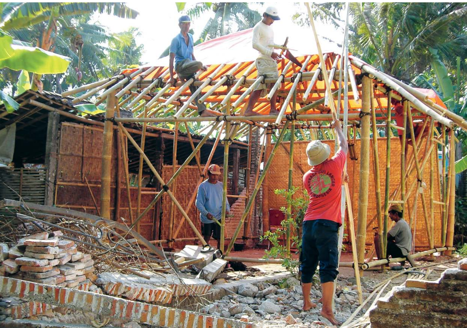
INDONESIEN Sida stödjer IFRC:s arbete för att bygga upp temporära hus efter jordbävningen på centrala Java i maj 2006. Husen byggs av bambu med traditionell byggteknik för att kunna stå emot framtida jordbävningar.
